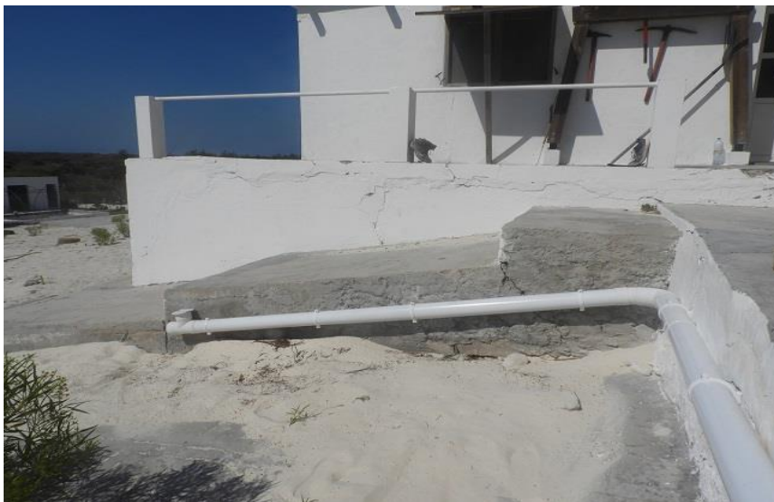
Façade sud de la station TAAF (aile droite) après creusement des saignée, pose des gouttières et des tubes de descente
