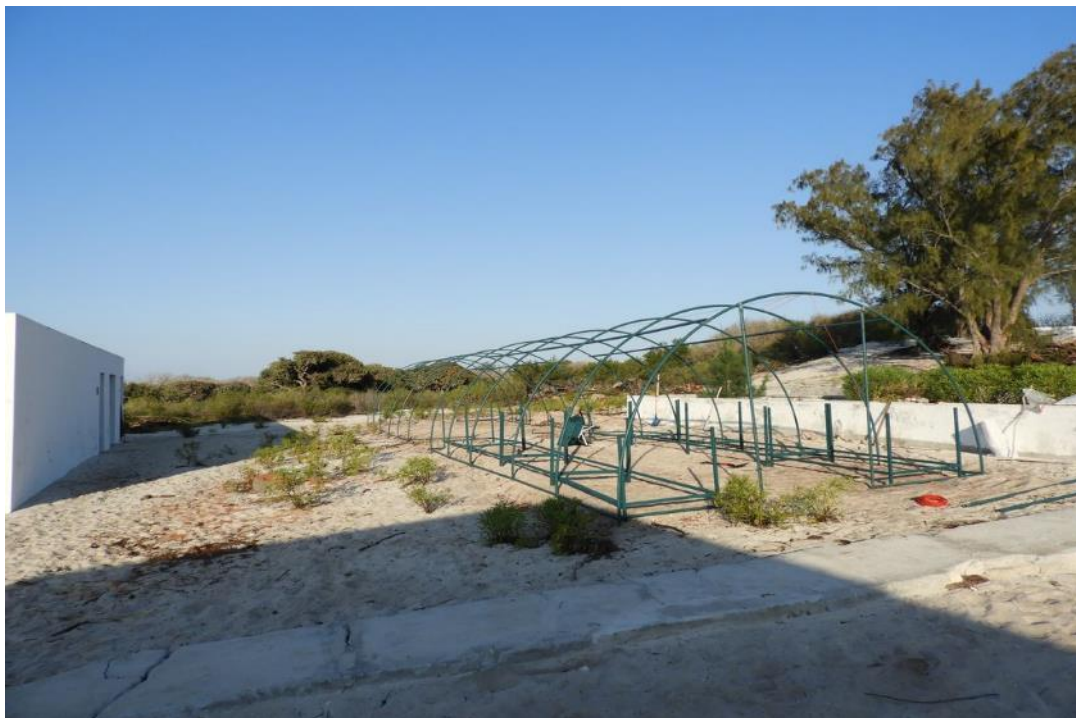
Totalement démontable la structure des deux tunnels est constituée d'une succession de 5 barres cintrées en acier renforcé galvanisé espacées d'1,5 m, reliées entre elles par des barres boulonnées à des croix de faitage. Au premier plan, sous le module 1, les pieds des tables montés sans leurs tabliers
