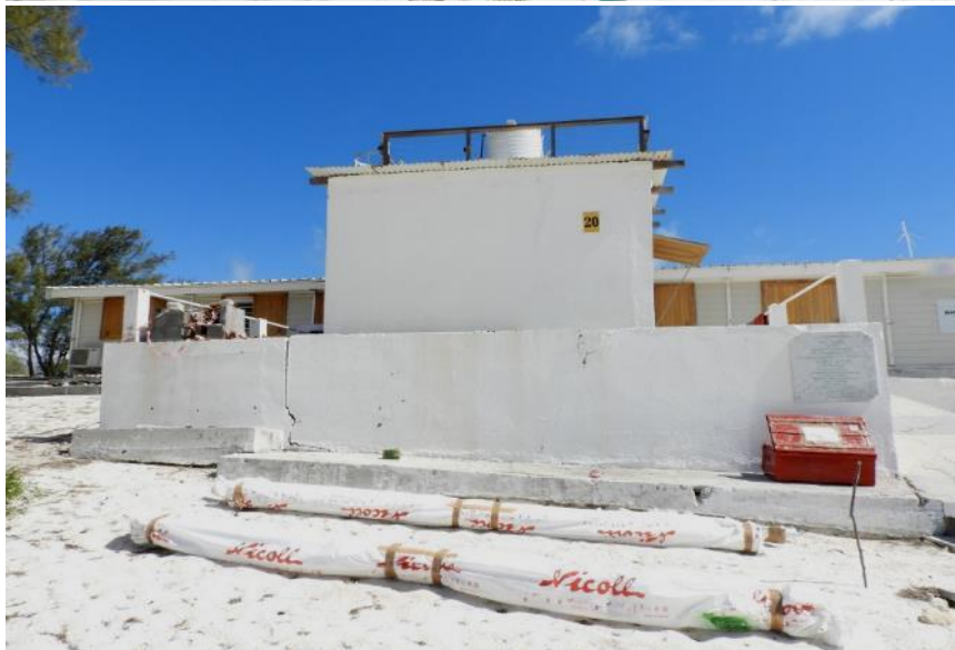
Façade sud de la station TAAF : état initial avant pause des gouttières. Les toitures de la station et de l'annexe 'cuisine' sont dans un état très convenable alors que les dalles de béton présentent de nombreuses fissures et des points d'éclatement
